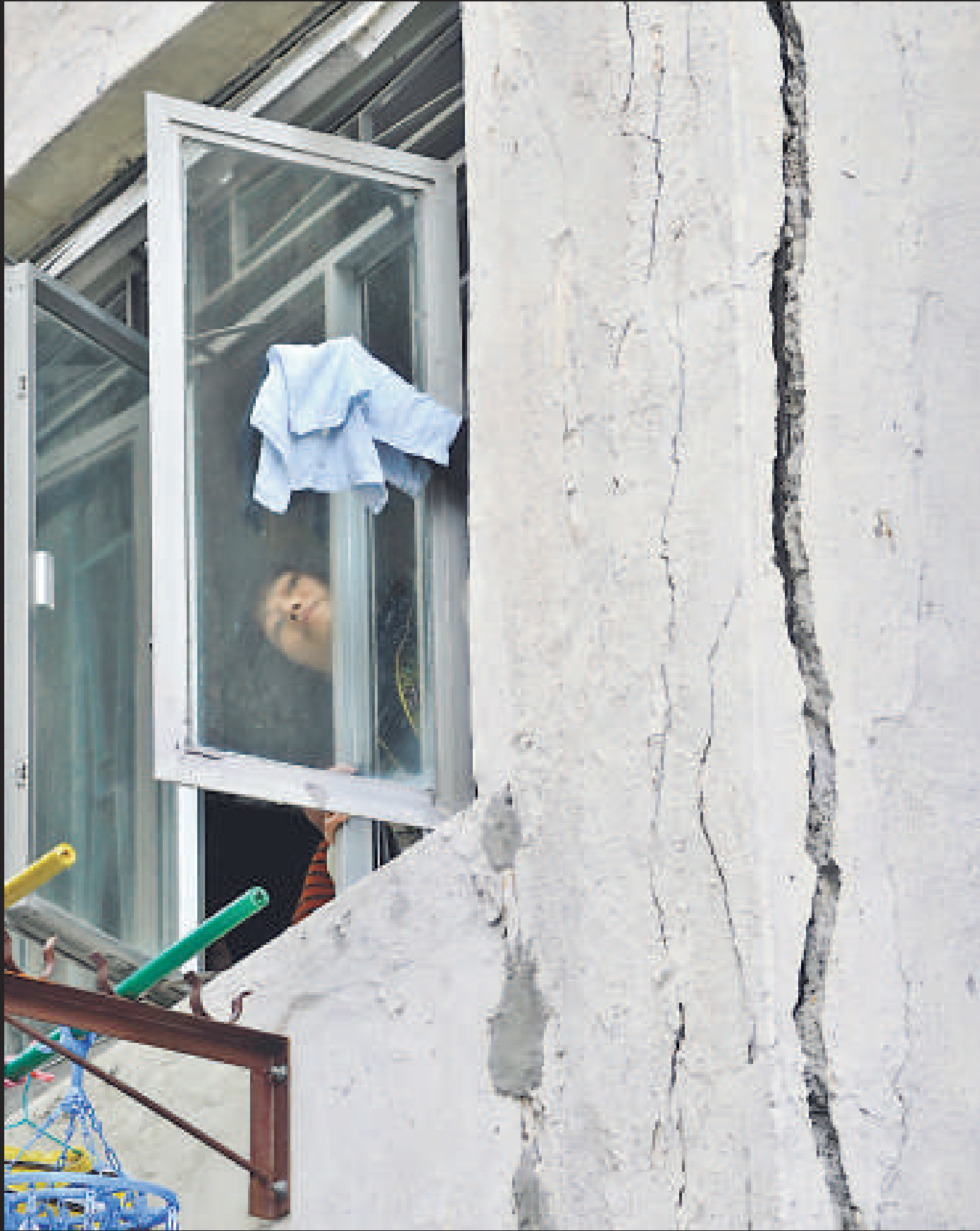
嚇至失眠 正在抹窗的鄭太與家人住在土瓜灣興賢街一幢舊樓，自塌樓慘劇發生後，其居所外牆一條由地下直伸延至3、4樓的垂直裂縫（見圖右）令她整晚失眠。
